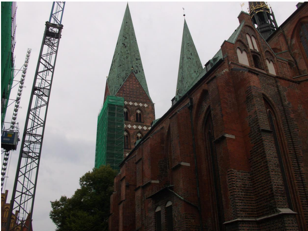
Abb.1: Die Marienkirche in Lübeck mit eingerüstetem Turm, in dem trotz Bauarbeiten die Wanderfalken erfolgreich drei Junge aufziehen konnten. Foto: W. Peschel
